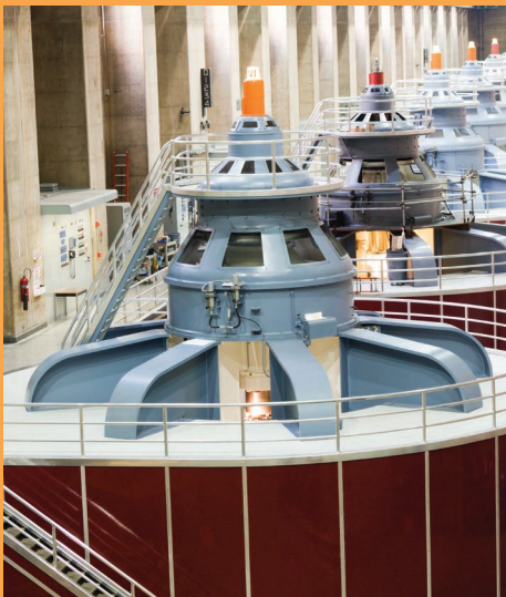
Turbinas en una planta generadora.
